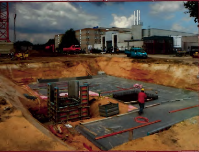
Für die Teilunterkellerung des Neubaus ging es im Juni 2011 erst einmal eine Etage nach unten.
