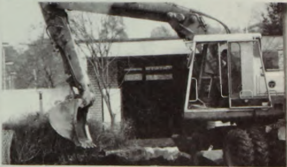
Frage: Was sucht der Bagger auf der Kartellterrasse? Er sucht die alten Rohrleitungen für den Beckenanschluß, um sie zu erneuern.
