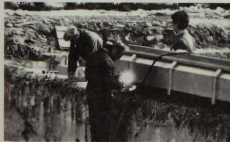
Überlaufrinne mit Seitenwand werden im Nichtschwimmerbecken montiert. Zu erkennen ist unser Bademeister, der die Mauer fachgerecht abstützt.
